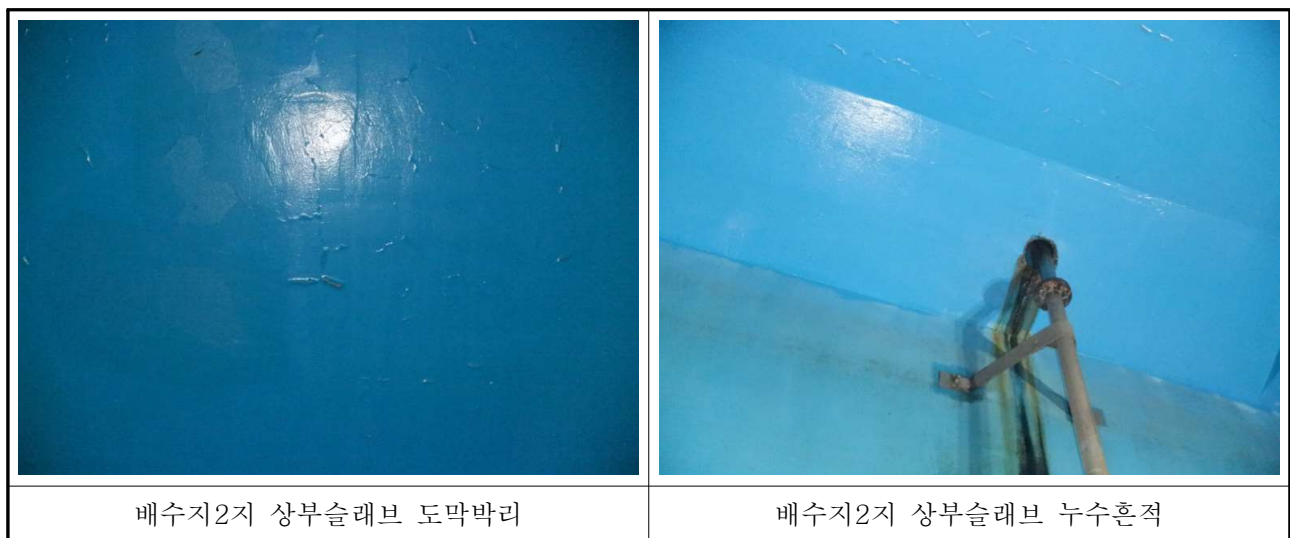
【사진 3.3】 배수지 2지 손상사진
