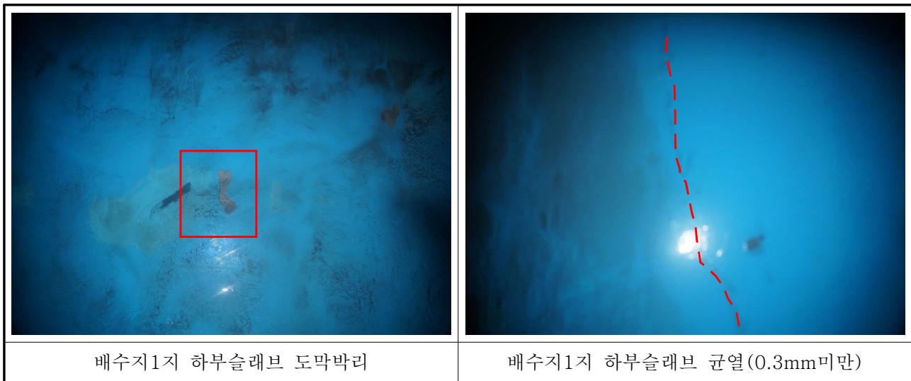
【사진 3.2】 배수지 1지 손상사진(계속)
