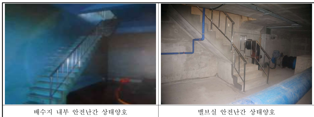
【사진 3.7】 안전시설(점검로) 손상사진
