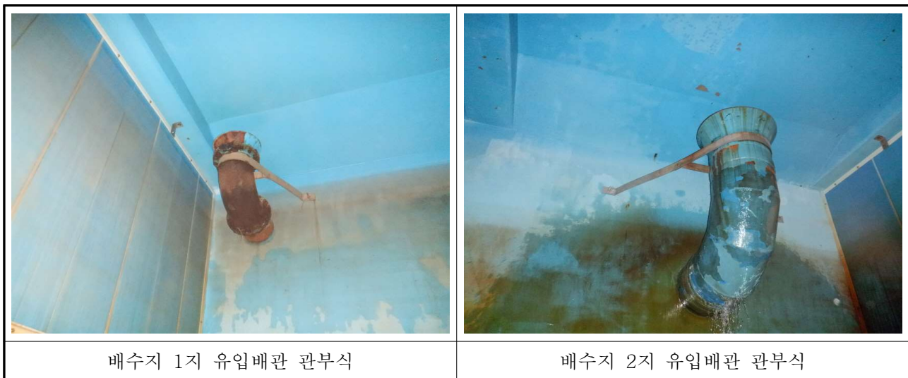
【사진 3.6】 기전설비 손상사진
